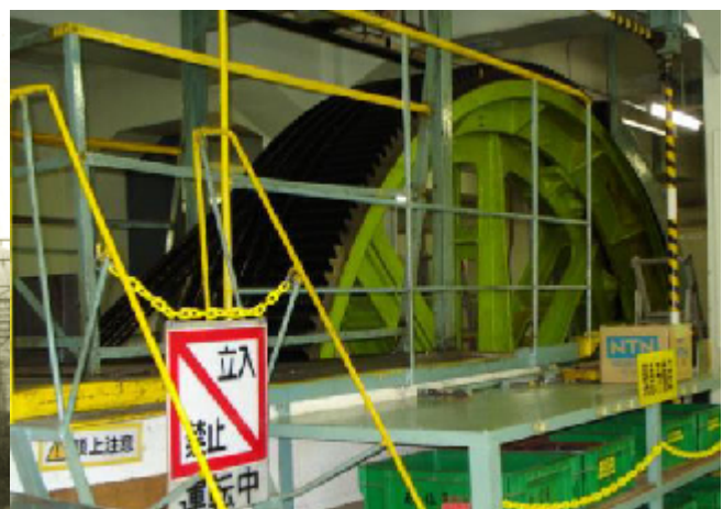
西信貴鋼索線ケーブル巻上げ所（高安山駅）
