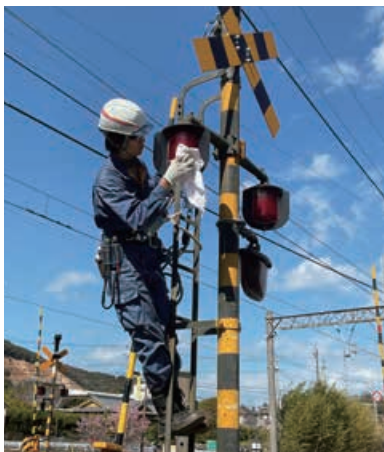
①踏切保安装置検査（警報灯）
