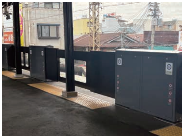
鶴橋駅4番線ホーム(大開口ホーム柵)
