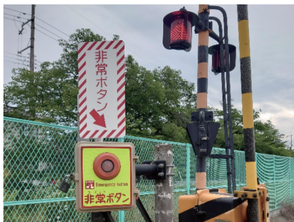
押ボタン式踏切支障報知装置
