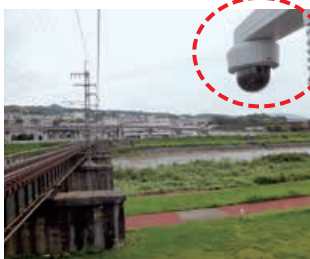
河川監視カメラ（生駒線 大和川橋梁）
