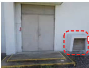
対策前（北楠変電所）
