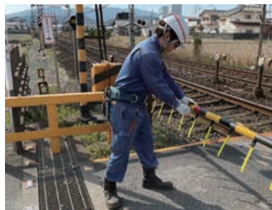
②踏切保安装置検査（遮断桿）
